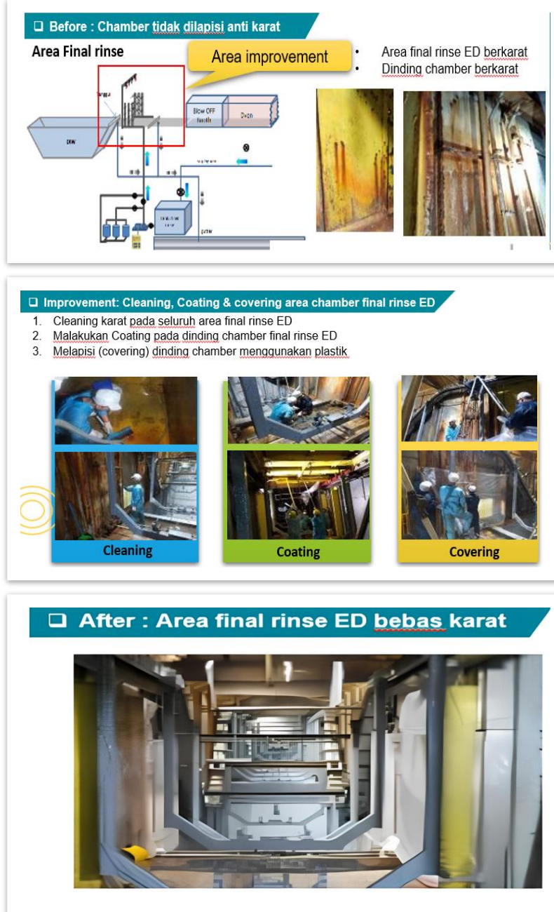
Gambar 4. Dokumentasi Perbaikan Chamber: Kondisi Awal (Atas), Tiga Tahap Cleaning-Coating-Covering (Tengah), Dan Kondisi Setelah Perbaikan (Bawah).
