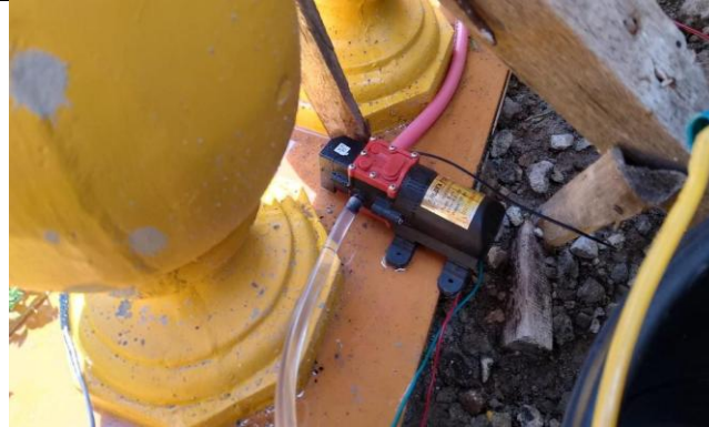
Gambar 6 Implementasi Pompa Air
