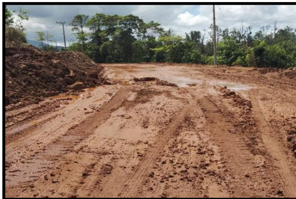
Gambar 14. Jalan hauling licin akibat hujan
