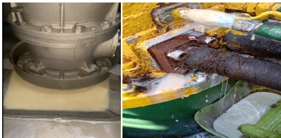
Gambar 8. Kebocoran Minyak pelumas hidrolis Dari Pompa (Sumber: Dokumen MT. Bintulu)
