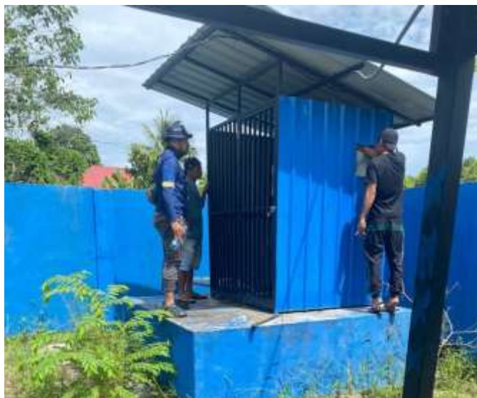
Gambar 1 Pengecekan mesin pompa air untuk jaringan Desa Wawolaa Raya Kec. Wawonii Barat Kabupaten Konawe Kepulauan Provinsi Sulawesi Tenggara Sumber : Data Primer (2025)
