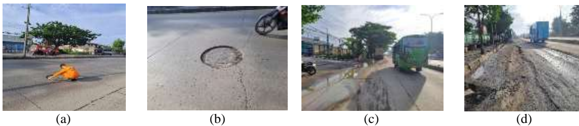
Gambar 5. Kondisi Jalan pada STA 1+900-2+500 (a) patching (b) potholes (c) Depression (d) Alligator Cracking
