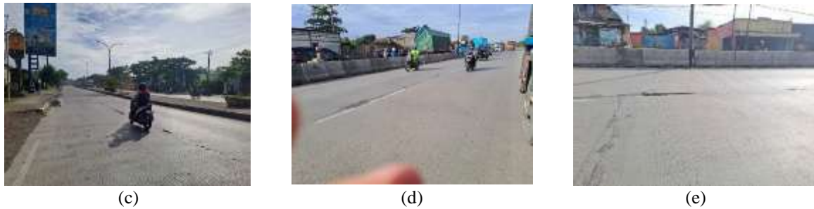
Gambar 4. Kondisi Jalan pada STA 0+500 - 1+900 (c) Longitudinal/Transverse Cracking (d) patching (e) patching
