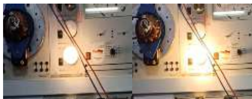
Gambar 11 Kondisi Lampu LED Saat dan Sesudah Perpindahan ATS Pada Uji Kelima
