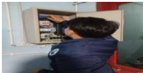
Gambar 16. Pemeriksaan Solar Charge Controller (SCC)
