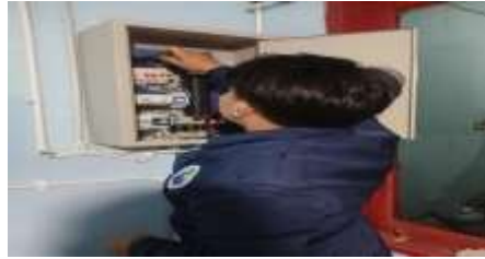
Gambar 12. Pemeriksaan Solar Charge Controller (SCC)
