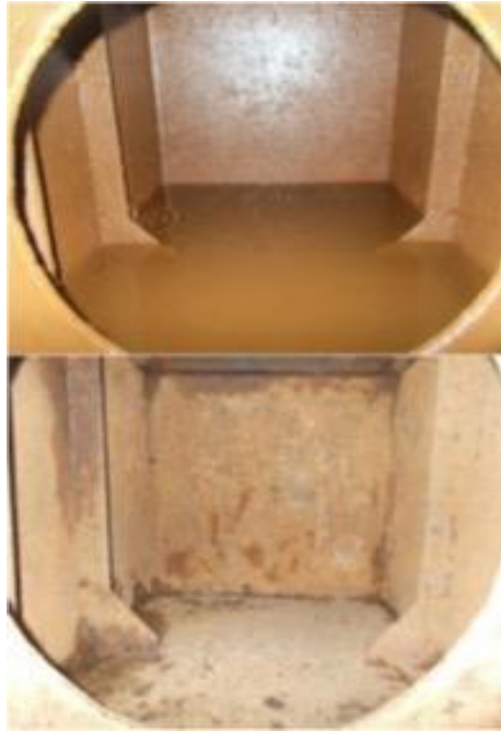
Gambar 4. Tangki Ekspansi jacket cooling Main Engine Sumber: Penulis (2024)
